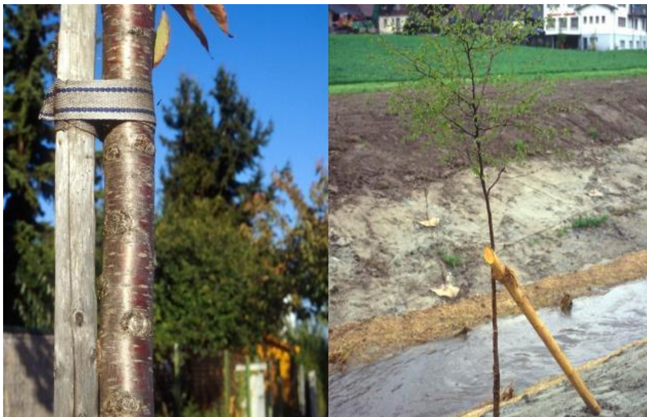
ABBILDUNG 17: SCHLECHTE EINPFAHLSTÜTZUNG UND SCHRÄGPF AHLSTÜTZUNG
